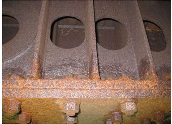
図 6.5 金属劣化の事例
