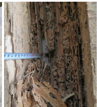
図 6.3 蟻害を受けた柱
