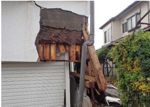
図 6.4 腐朽と蟻害で耐震性を失った事例 （撮影：広島大学 森准教授）
