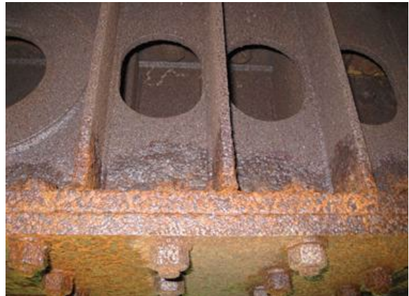
図 6.5 金属劣化の事例
