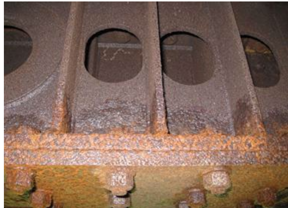
図 6.5 金属劣化の事例
