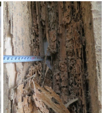
図 6.3 蟻害を受けた柱
